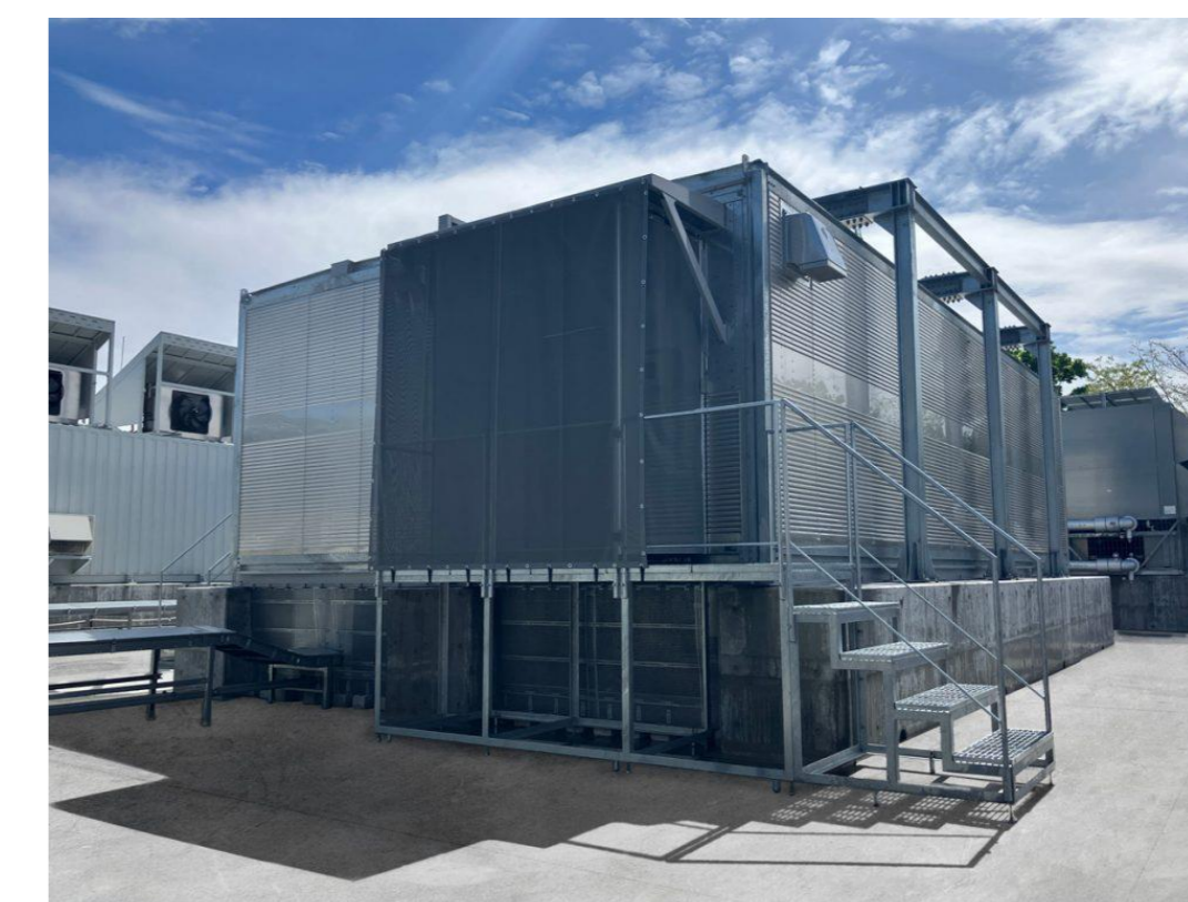
コンテナ型データセンター
