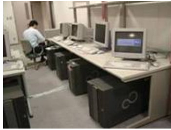
つくばJGNⅡリサーチセンターのサーバ
