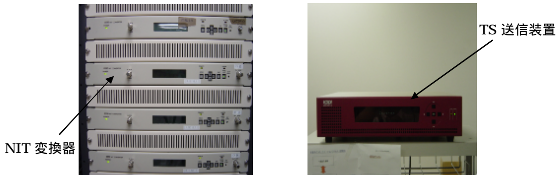
図2 メディアス側 送信設備
