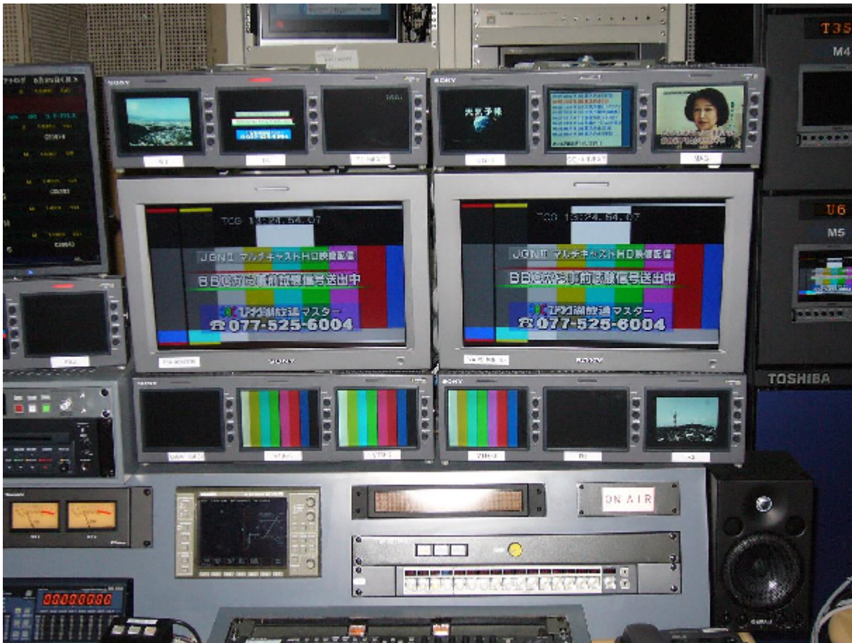
写真 各放送局との接続確認中のびわ湖放送マスター
