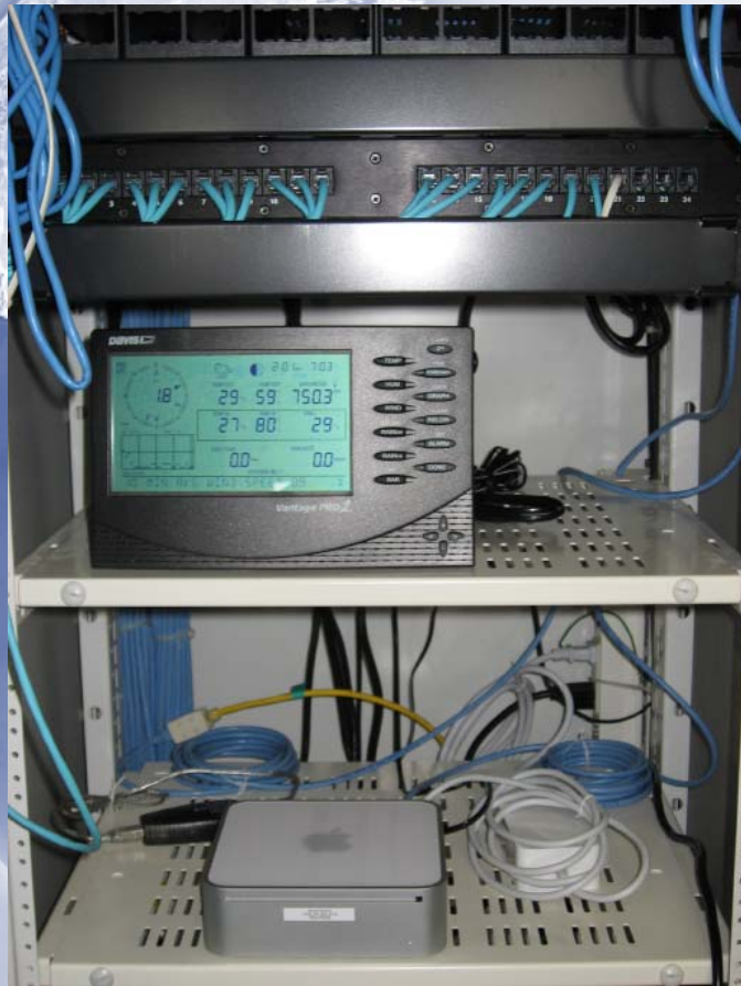
8階EPS内N/Wラック内
