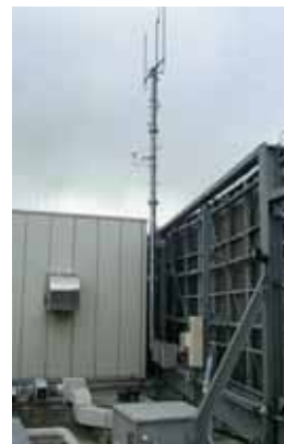
2GHz帯基地局屋外部
